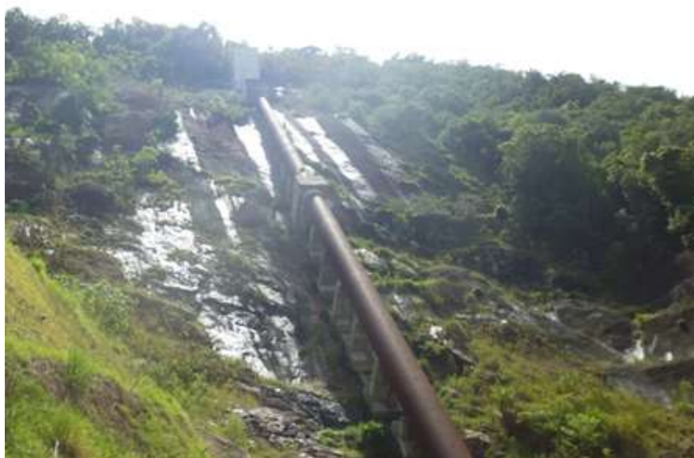
Foto 12 – Vista do conduto forçado e da chaminé de equilíbrio que se interliga ao túnel de adução.
